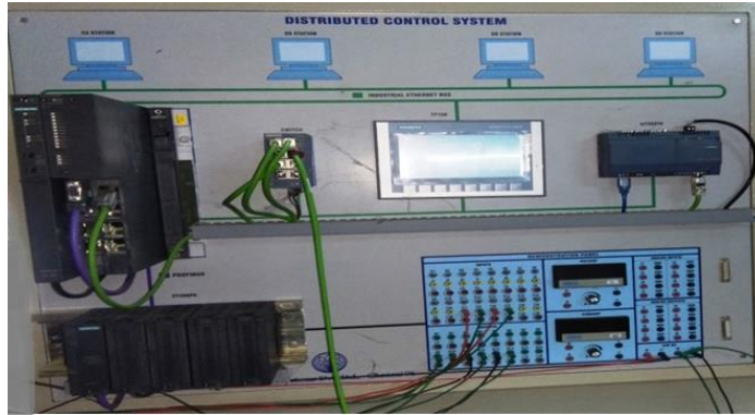
Fig. 3. SIEMENS DCS Hardware
